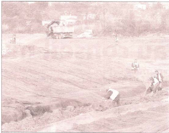
Les ouvriers installent un géotextile biodégradable recouvert d'un grillage qui fixera les berges dont la pente douce domine les promenades piétonnes qui bordent le cours d'eau. (Photo Philippe Lambert)
